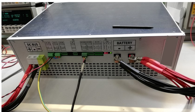
Convertitore DC-DC di interfaccia tra la DC-nanoGrid di progetto e la batteria a Flusso oggetto della campagna di misure ai fini della caratterizzazione sperimentale (ENEA)
